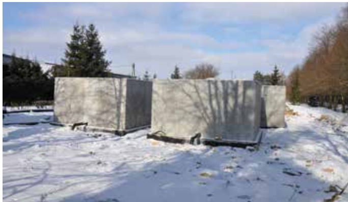
Zbiorniki w nowej części oczyszczalni ścieków
